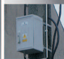
шкаф учета на столбе, вывод электрического кабеля и кабеля терминала на дом
